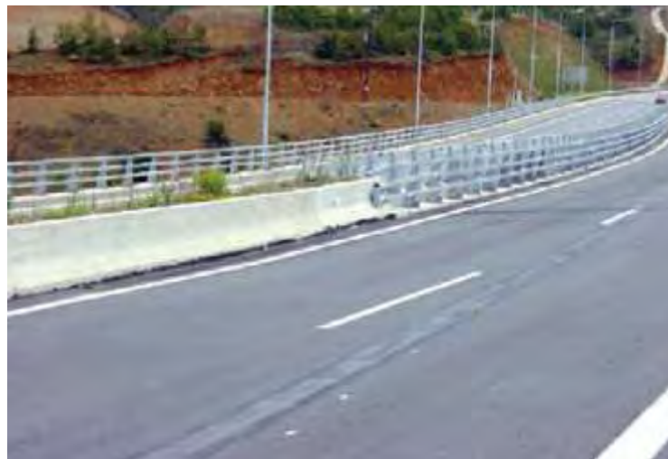
Συναρμογή στηθαίων σκυροδέματος ((New Jersey) και μεταλλικού στηθαίου γέφυρας σε ελληνικό αυτοκινητόδρομο
