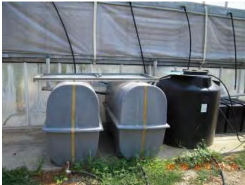
Δεξαμενές παρασκευής των αλατούχων διαλυμάτων νερού
