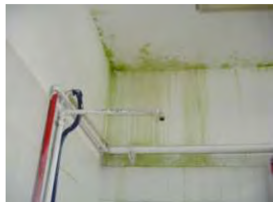
Εικόνα 6.15: Φθορές στην εσωτερική τοιχοποιία χώρων υγιεινής
