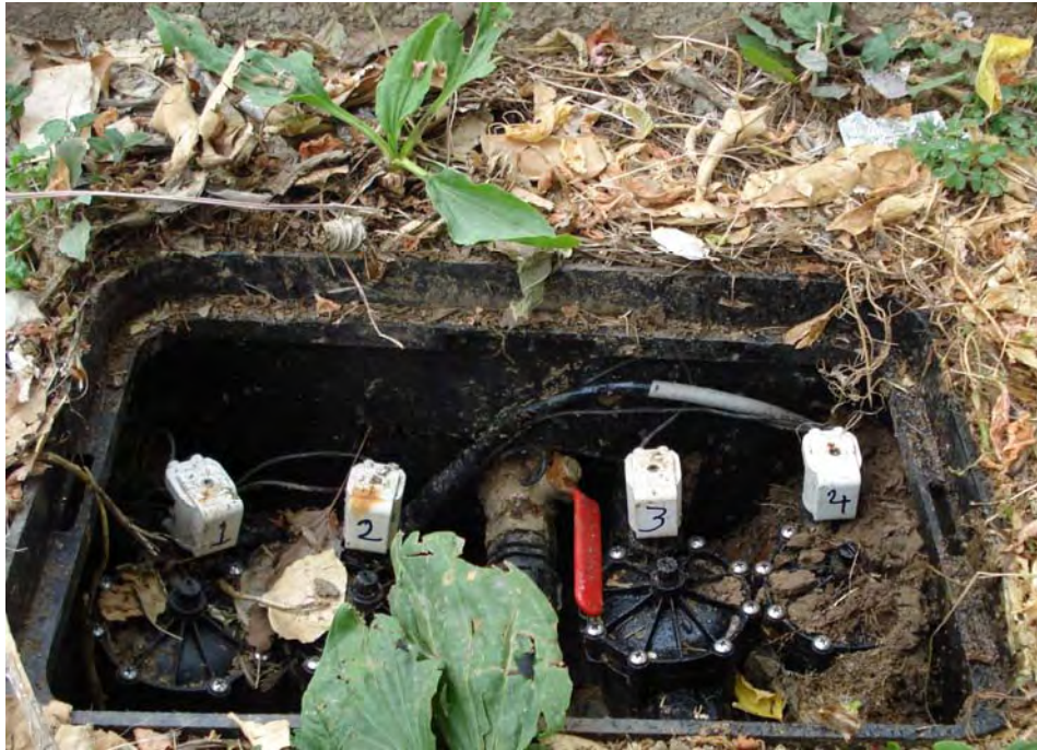
Εικόνα 29 Ηλεκτροβάνες Πλατεία Ζέρβα Ν. Ιωνία Μαγνησίας
