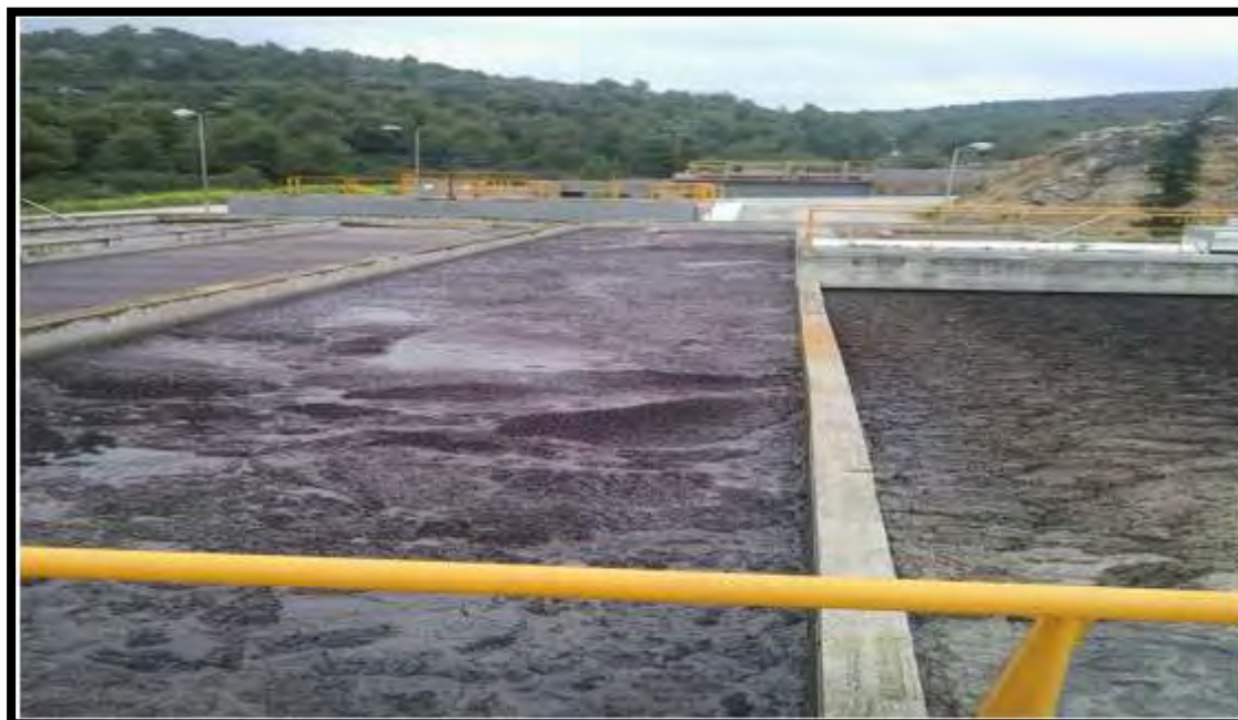
Εικόνα 12: Δεξαμενή αερισμού με επιφανειακό αερισμό. Χαμηλός δείκτης F:M
