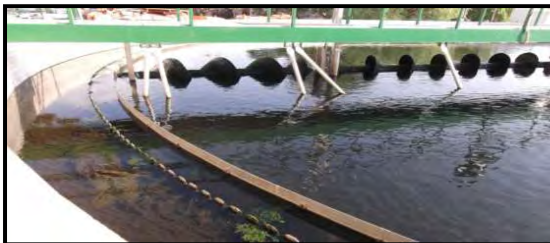
Εικόνα 16: Άλγη-φύκια στην υπερχείλιση της δεξαμενής καθίζησης.
