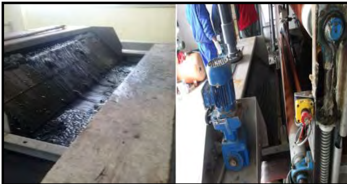
Εικόνα 18: Υδαρή ιλύς σε ταινιοφιλτροπρεσσα.
