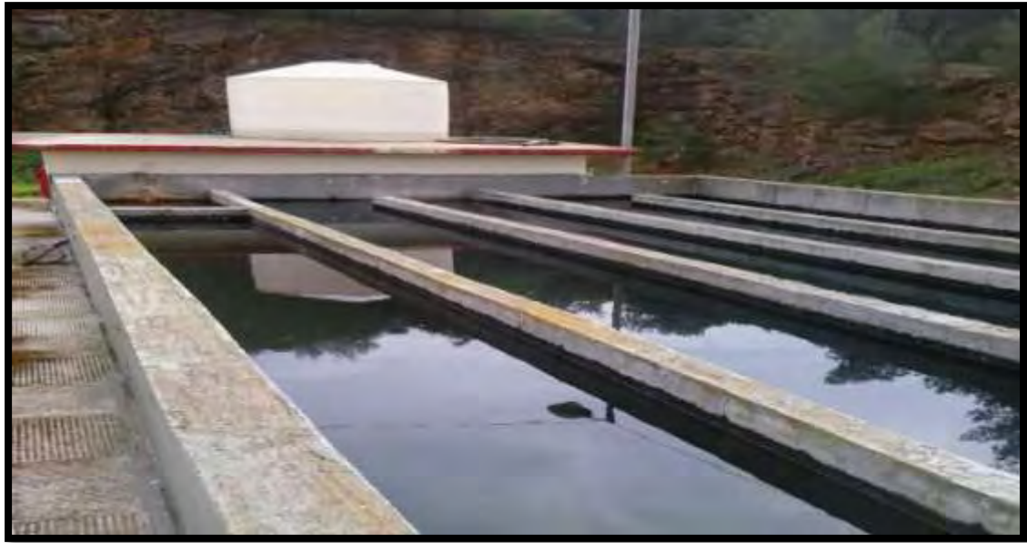
Εικόνα 20: Χλωρίωση επεξεργασμένων λυμάτων
