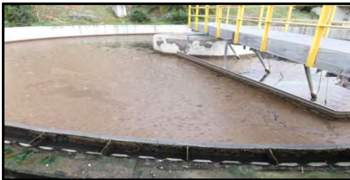
Εικόνα 15: Ανύψωση ιλύος σε δεξαμενή καθίζησης
