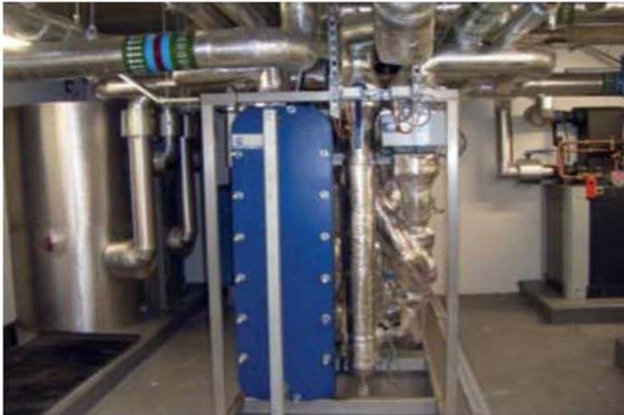
Εικόνα 6.5 Χώρος που περιέχει τους εναλλάκτες θερμότητας και τις βαλβίδες ελέγχου. (Πηγή εικόνας: [8])
