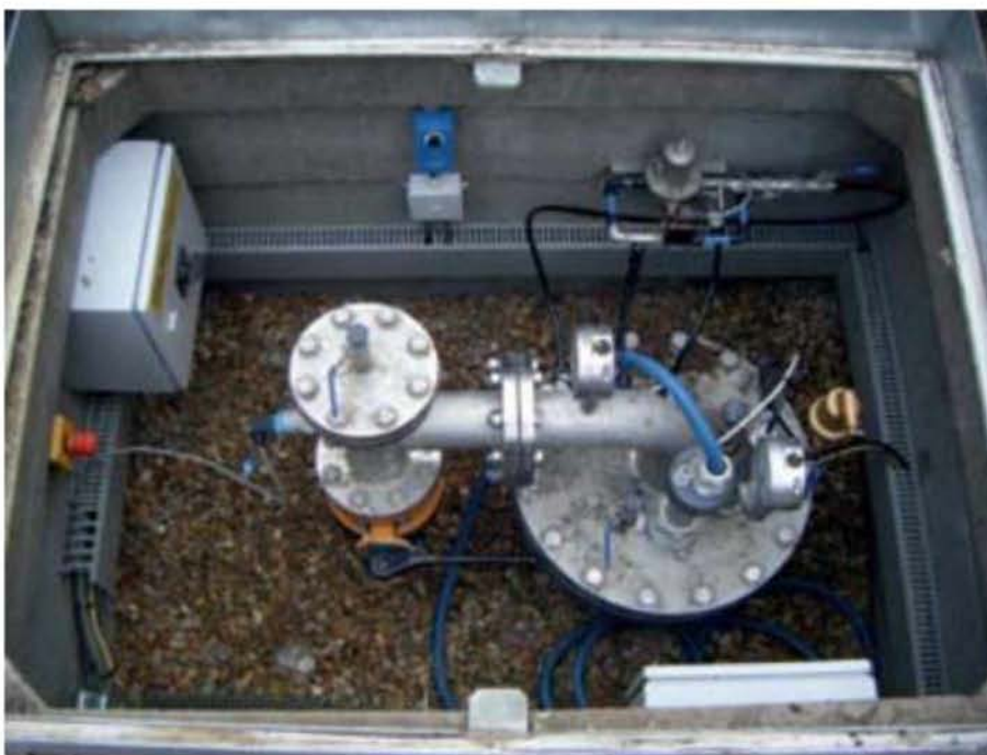
Εικόνα 6.6 Θάλαμος στο επίπεδο του εδάφους για μια γεώτρηση. (Πηγή εικόνας: [8])
