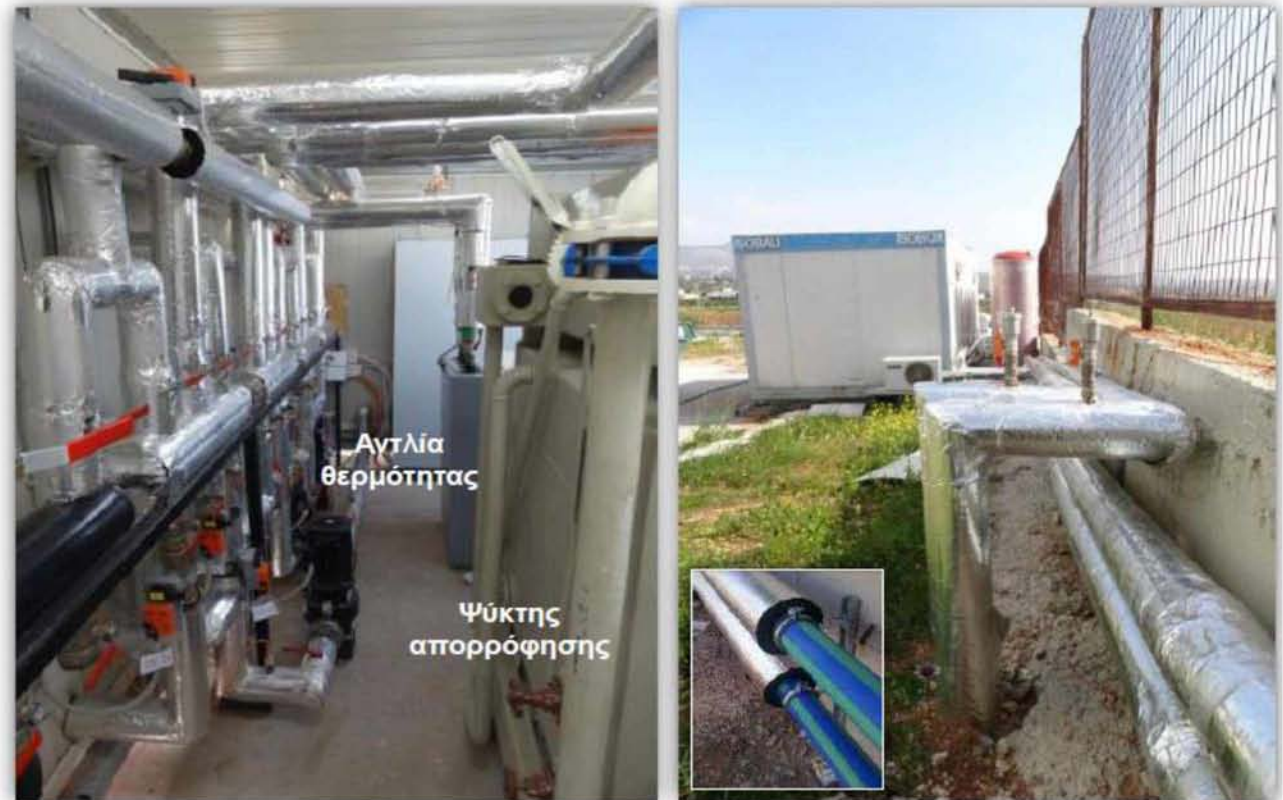
Εικόνα 6.13 Τμήμα της εγκατάστασης. (Πηγή εικόνας: [9])
