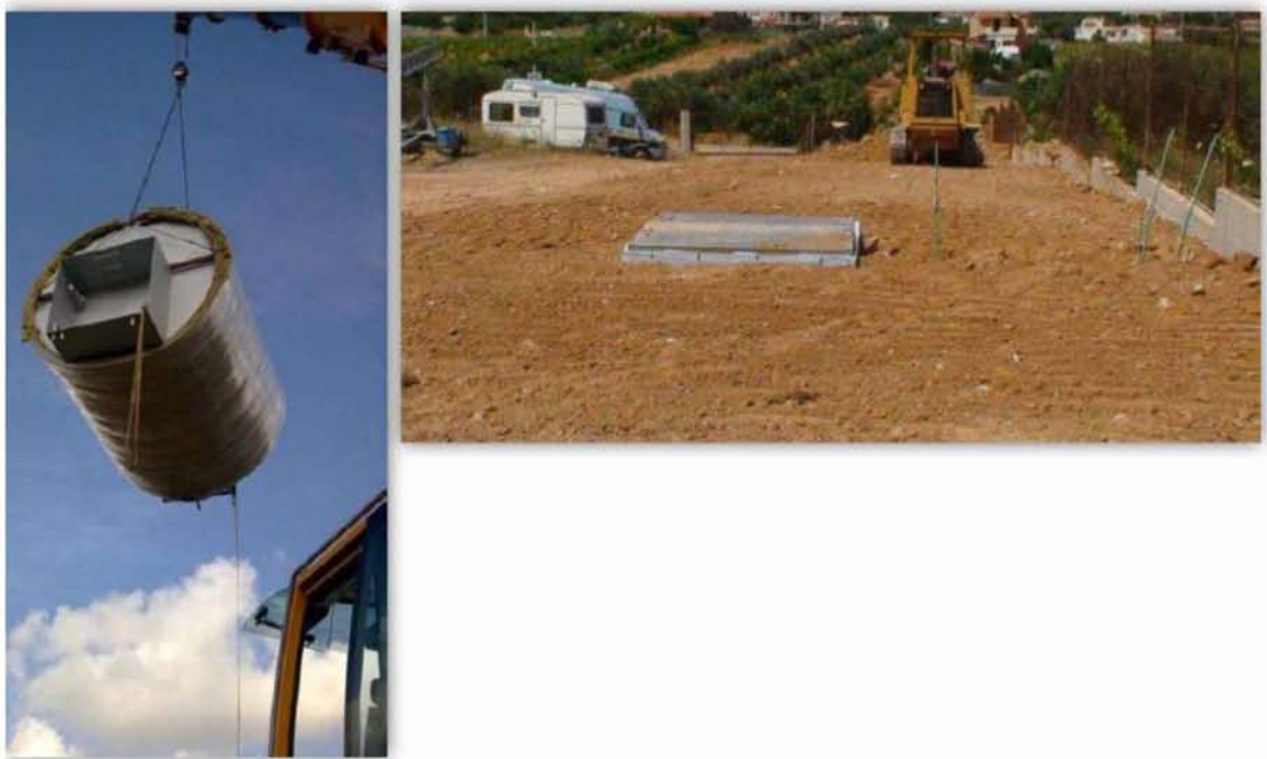
Εικόνα 6.12 Τοποθέτηση της αποθήκης θερμότητας. (Πηγή εικόνας: [9])
