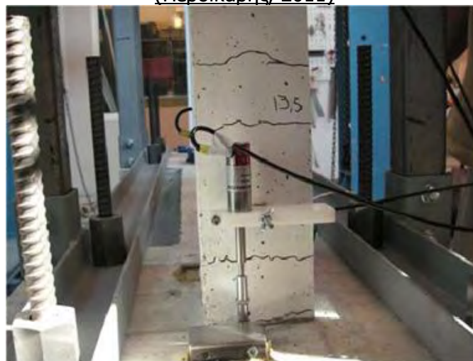
Σχήμα 3.1.9 : Ρηγμάτωση καθ' ύψος των υποστυλωμάτων (Περδικάρης, 2011)
