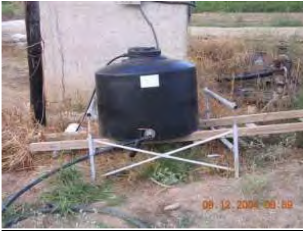
Φωτ. 1. Η δεξαμενή του FDS.
