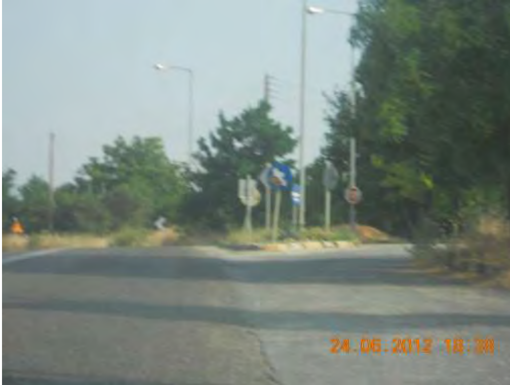
ΕΙΚΟΝΑ 4.2: Χ.Θ. 1+100 – Ισόπεδος κόμβος, έλλειψη διαγράμμισης, κακή σήμανση
