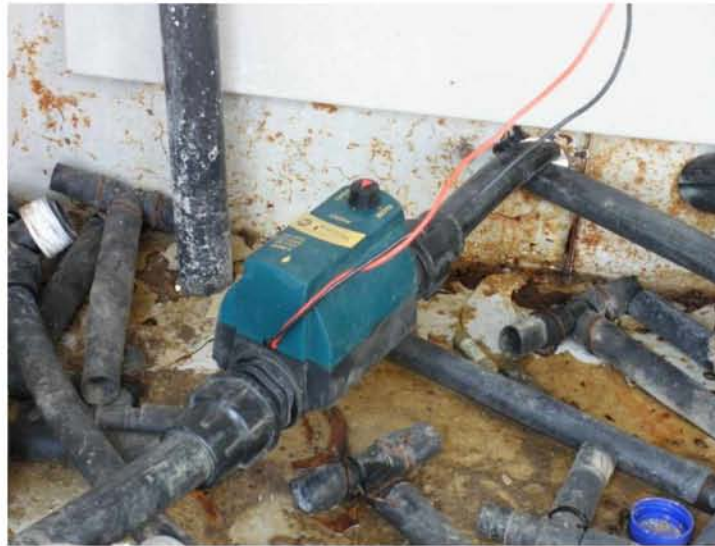
Εικόνα 5.6.4. Η ηλεκτροβάννα που χρησιμοποιούνταν για την άρδευση με καθαρό νερό.
