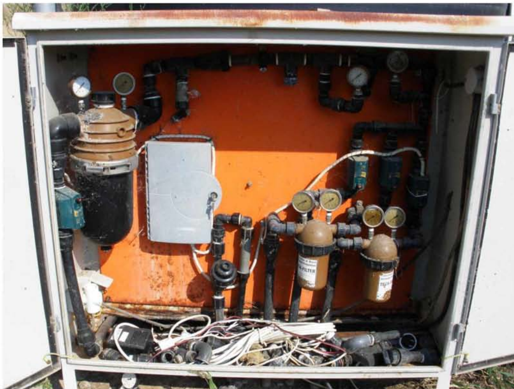
Εικόνα 5.6.12. Μηχανολογικός εξοπλισμός που περιλαμβάνει την ηλεκτροβάννα του λύματος, φυλασσόμενος σε ειδικά διαμορφωμένο κουτί.
