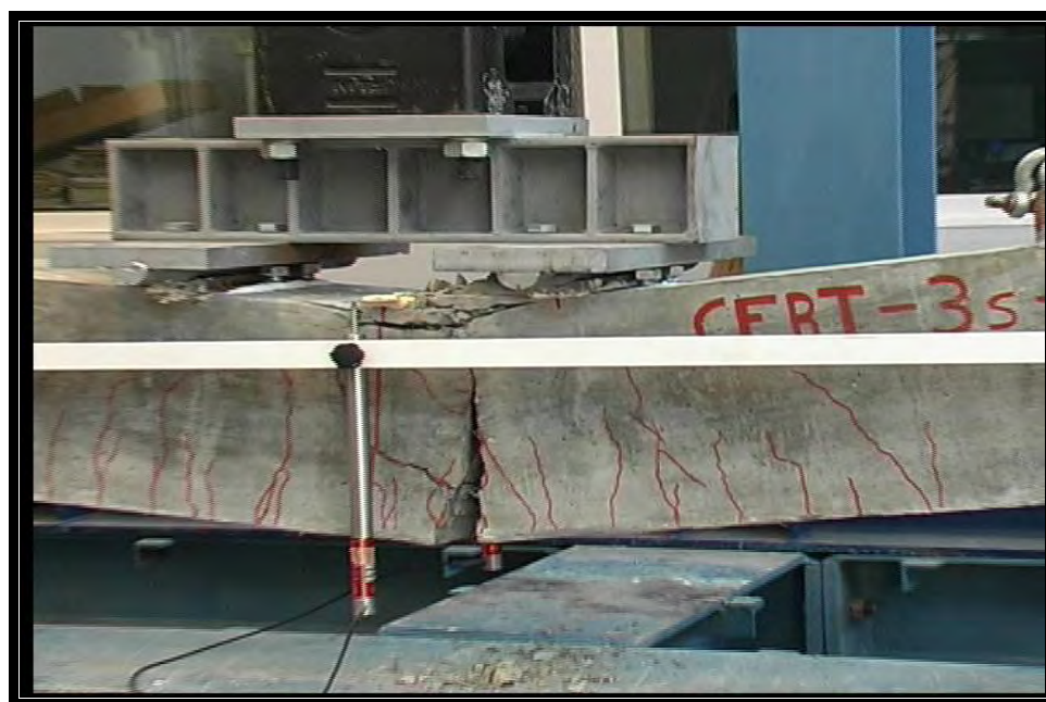
Σχ. 3 - Λεπτομέρεια της περιοχής αστοχίας.
