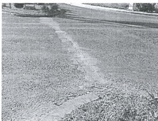
Φωτογραφία ΙΧ.10. Τοπική ανισοσταθμία στην εσωτερική ζώνη του κόμβου
