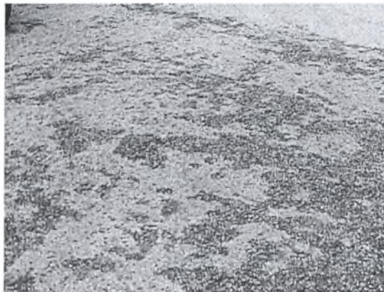
Φωτογραφία VI.6. Αποφλοίωση του οδοστρώματος επί της οδού Βάρναλη
