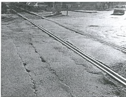
Φωτογραφία VIII.4. Ανισοσταθμία επί της οδού Θερμοπυλών
