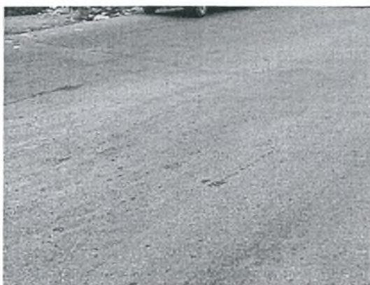
Φωτογραφία I.11. Εμφάνιση αυλακώσεων επί του οδοστρώματος
