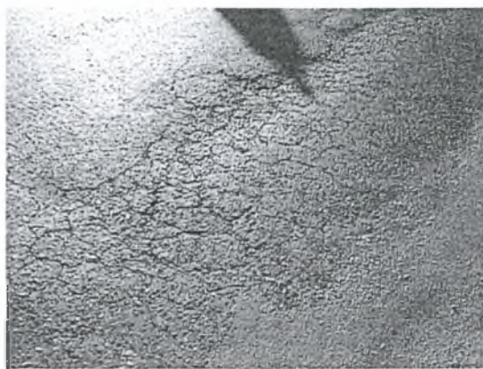
Φωτογραφία ΙΧ.9. Εμφάνιση αλλιγοτορικών ρωγμών επί της οδού Στυλίδος
