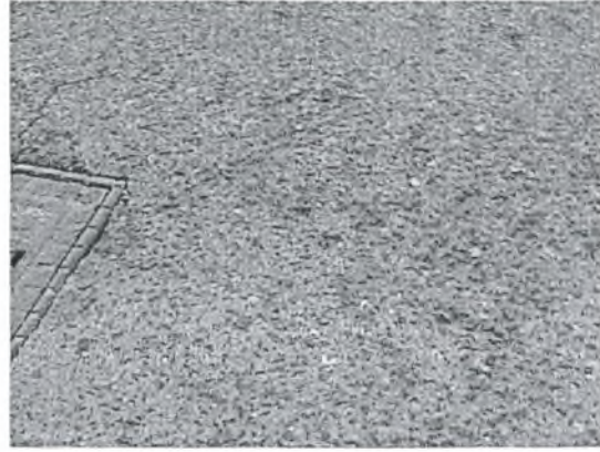
Φωτογραφία Χ.5. Αποφλοίωση του οδοστρώματος της οδού Παπαποστόλου
