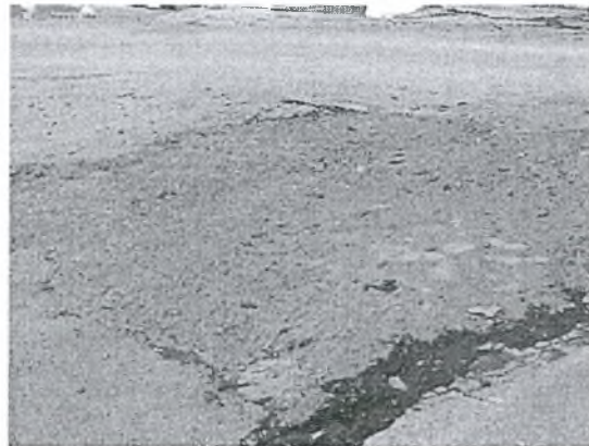
Φωτογραφία Χ.6. Ανισοσταθμία οδοστρώματος λόγω τοπικών επισκευών
