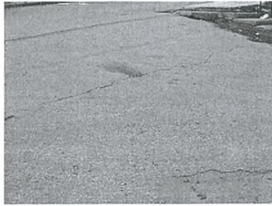
Φωτογραφία IV.9. Τοπική ανισοσταθμία λόγω τοπικών επισκευών
