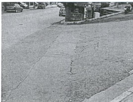
Φωτογραφία IV.8. Τοπική ανισοσταθμία λόγω τοπικών επισκευών
