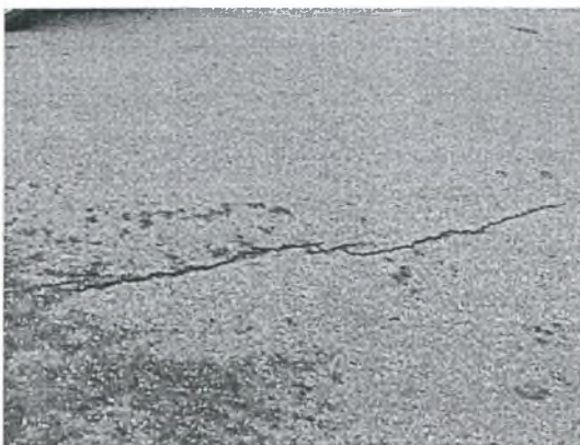
Φωτογραφία I.12. Εμφάνιση διαμηκών ρωγμών επί του οδοστρώματος
