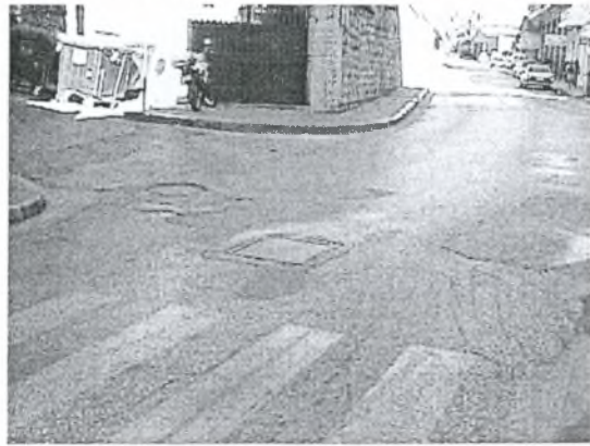
Φωτογραφία VII.6. Ανισοσταθμία οδοστρώματος λόγω τοπικών επισκευών
