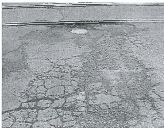
Φωτογραφία I.9. Αλλιγατορικές ρωγμές - αποσύνθεση του οδοστρώματος
