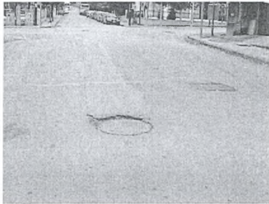
Φωτογραφία ΙΙΙ.6. Τοπική ανισοσταθμία λόγω τοπικών επισκευών
