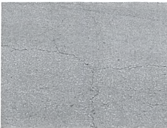
Φωτογραφία IV.7. Εμφάνιση διαμηκών ρωγμών επί του οδοστρώματος
