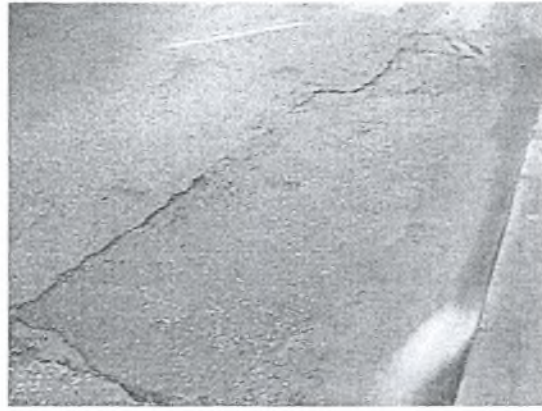
Φωτογραφία VII.5. Ανισοσταθμία οδοστρώματος λόγω τοπικών επισκευών
