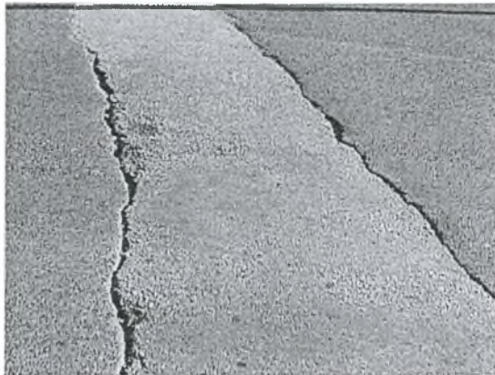
Φωτογραφία XIV.6. Μπαλώματα επί του οδοστρώματος
