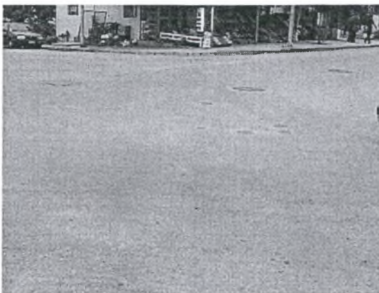
Φωτογραφία XII.6. Τοπική ανισοσταθμία λόγω τοπικών επισκευών
