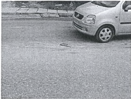
Φωτογραφία 1.7. Εμφάνιση κοιλώματος επί του οδοστρώματος
