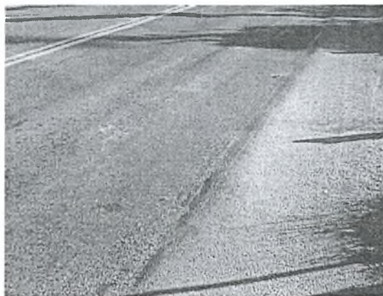
Φωτογραφία ΙΧ.8. Εμφάνιση αυλακώσεων επί του οδοστρώματος της Π.Ε.Ο
