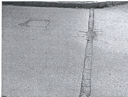
Φωτογραφία VI.7. Ανισοσταθμία λόγω τοπικών επισκευών του οδοστρώματος
