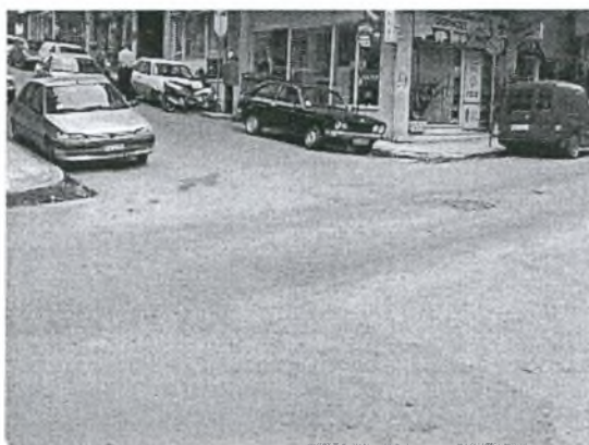
Φωτογραφία V.3. Ανισοσταθμία λόγω αυλακώσεων και τοπικών επισκευών
