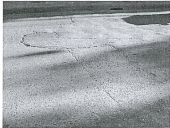
Φωτογραφία VIII.6. Ανισοσταθμία λόγω τοπικών επισκευών
