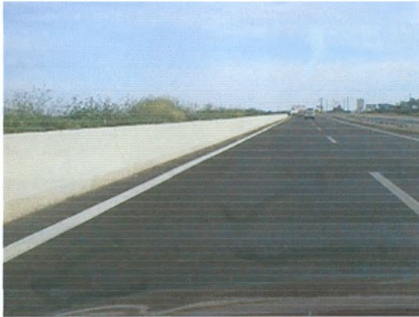
ΦΩΤΟΓΡΑΦΙΑ 1. Λωρίδα New Jersey-πλήρωση με φυτική γη. Θα χρησιμοποιηθεί στην κατασκευή της κύριας και δευτερεύουσας οδού.
