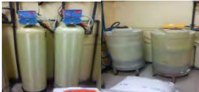
Εικόνα 10.1. Αποσκληρυντές – Δεξαμενές αποθήκευσης χλωριούχου νατρίου
