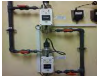
Εικόνα 10.6. Εγκατάσταση υπεριώδης ακτινοβολίας UV
