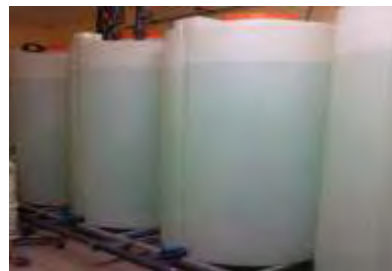
Εικόνα 10.8. Δεξαμενές αποθήκευσης επεξεργασμένου νερού
