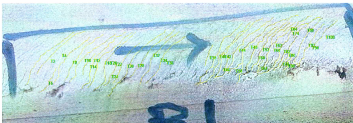
Σχήμα 4.5 Μέτρηση μήκους ρωγμών στην περιοχή B1
