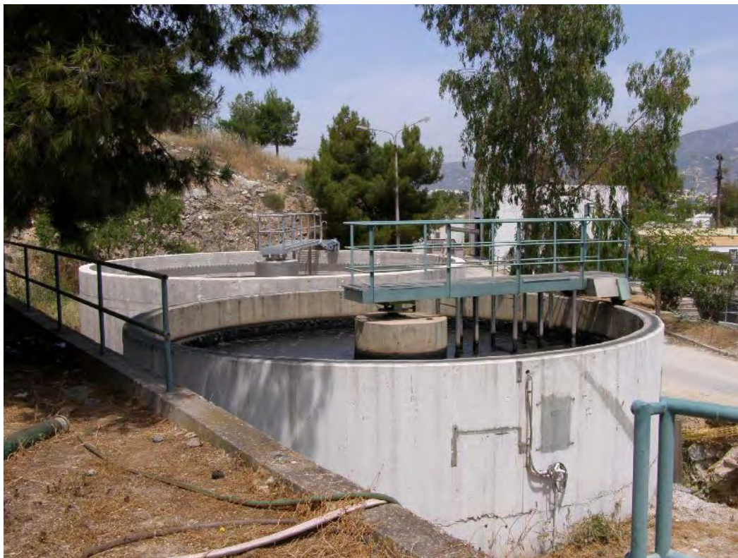
Εικόνα 2.5: Δεξαμενές μεταπάχυνσης της λυματολάσπης.
