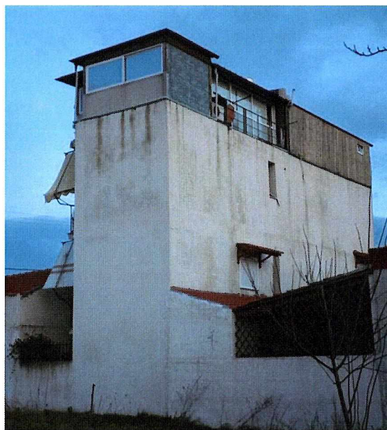
Εικόνα 62 Αυθαίρετη Επέκταση Κατασκευής _σε Όροφο
