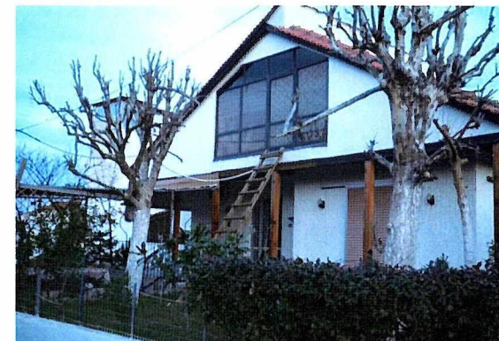
Εικόνα 63 Αυθαίρετη Επέκταση Κατασκευής _σε Όροφο Χωρίς Εύκολη Πρόσβαση
