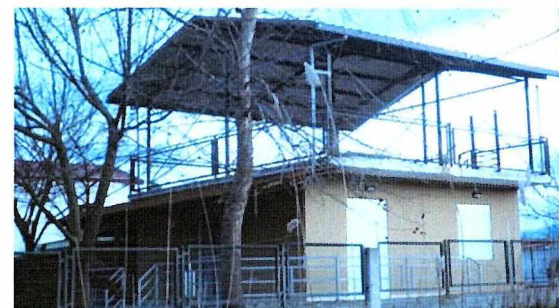
Εικόνα 70 «Εν Δυνάμει» Κάθετη Επέκταση _Αυθαιρέτο Στέγαστρο
