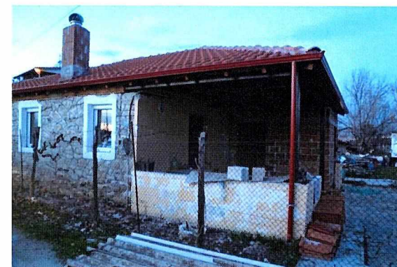
Εικόνα 59 Αυθαίρετη Κατασκευή με Οριζόντια Επέκταση του Χώρου και της Βεράντας
