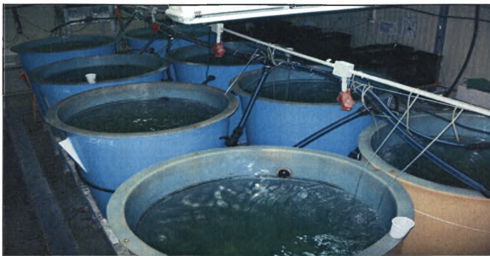
Εικόνα 8. Γενική άποψη του εσωτερικού του σταθμού - συστοιχίες δεξαμενών των 500 lt.
