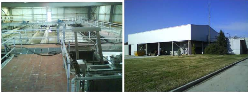
Εικόνα 4.6 – 4.7: Εσωτερικό και εξωτερικό μονάδας εξάμμωσης στην ΕΕΛ Λάρισας.
