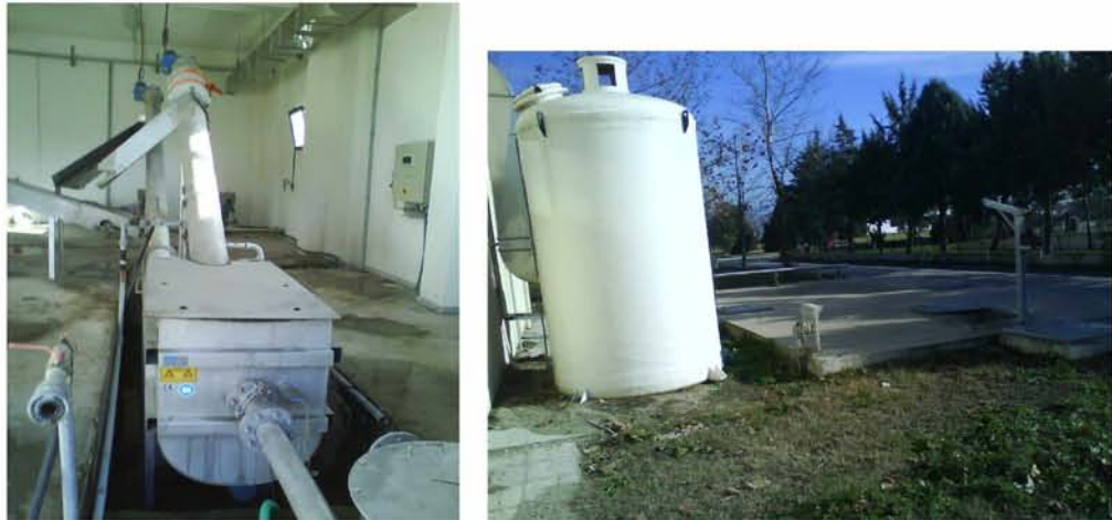
Εικόνα 4.1 – 4.2: Μονάδα επεξεργασίας βοθρολυμάτων και φίλτρο απόσμησης στη ΜΕΥΑ Λάρισας
