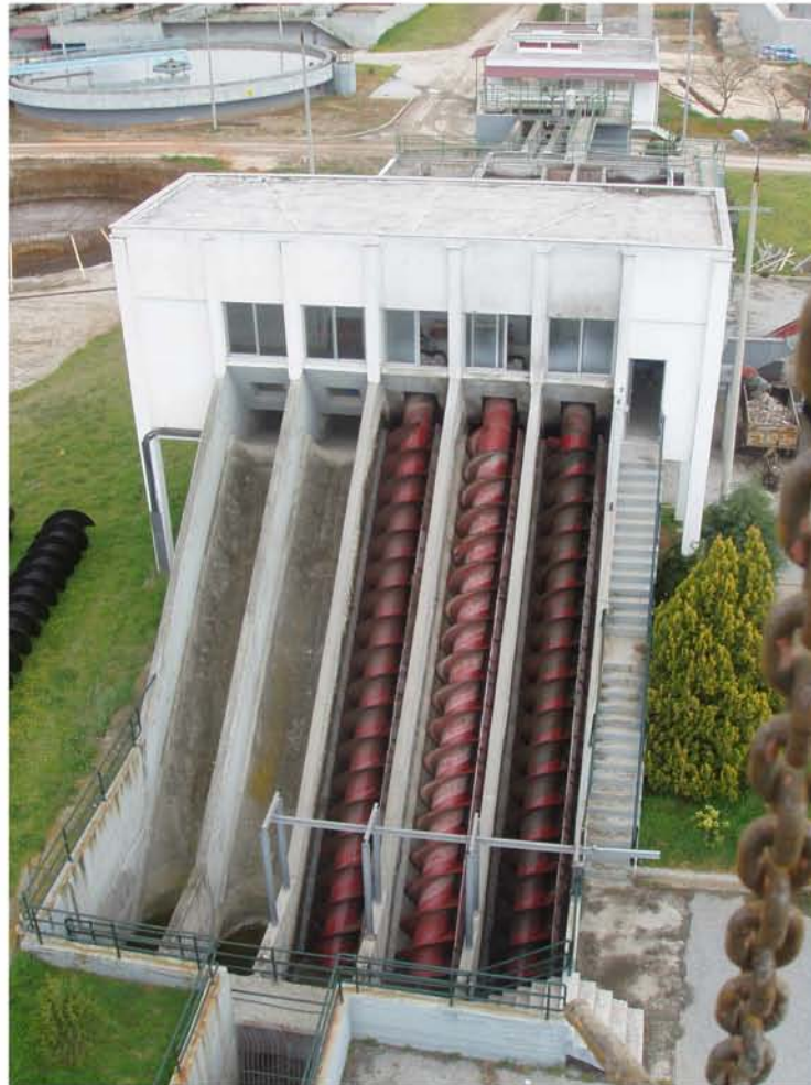
Εικόνα 4-5: Ανυψωτικοί κοχλίες τύπου Αρχιμήδη στην ΕΕΛ Λάρισας
