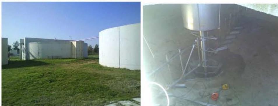
Εικόνα 4.16 – 4.17: Εξωτερικό και εσωτερικό παχυντή ιλύος.
