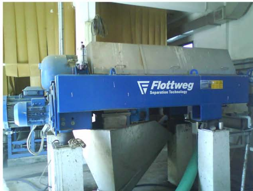
Εικόνα 4-19: Μονάδα μηχανικής αφυδάτωσης στην ΕΕΛ Λάρισας.
