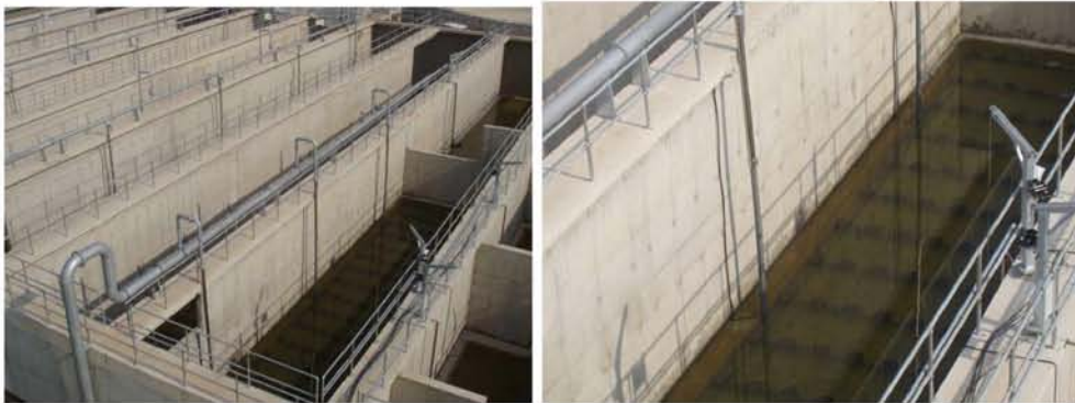
Εικόνα 4.10 – 4.11: Αερισμός κατά την διάρκεια μη λειτουργίας της μονάδας
