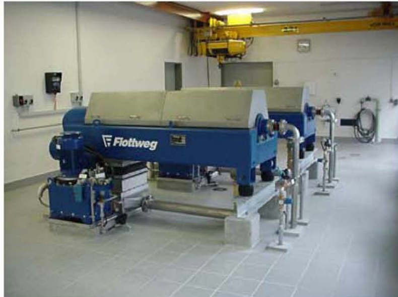
Εικόνα 4-18: Μονάδα μηχανικής πάχυνσης ιλύος.
