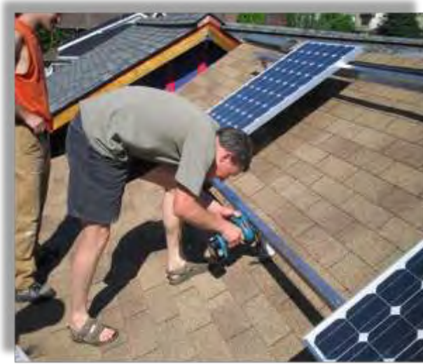
Εικόνα 4: μεταλλικός σκελετός στήριξης φωτοβολταϊκών
