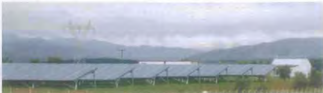
Εικόνα 3.6: Ηλιακός σταθμός ηλεκτροπαραγωγής στην Κρήτη
