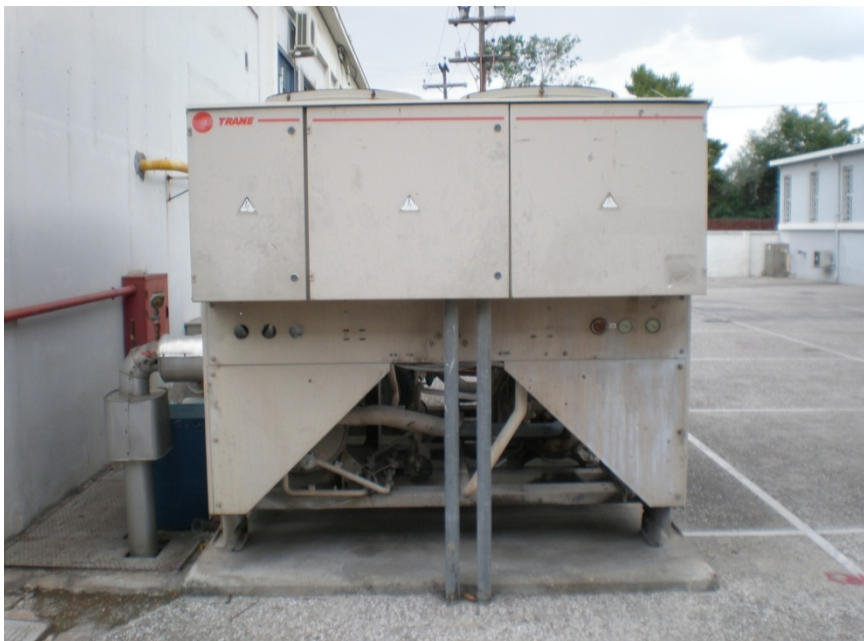
Εικόνα 88. Πλάγια όψη ψυκτικής μονάδας. Διακρίνονται οι ηλεκτρολογικοί πίνακες ελέγχου
