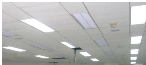
Εικόνα 93: Φωτιστικό σώμα τύπου 3– Αποτελείται από 2 λαμπτήρες T8 (2*36W)
