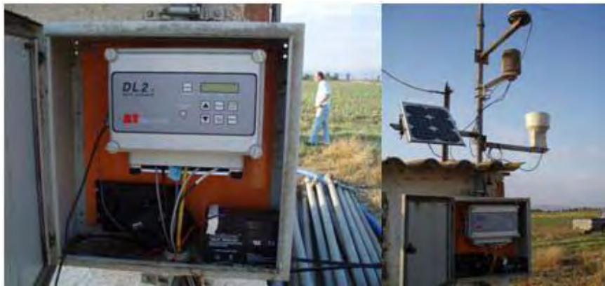
Εικόνα 2.3. Ο αυτόματος μετεωρολογικός σταθμός που εγκαταστάθηκε στον Παλαμά Καρδίτσας.
