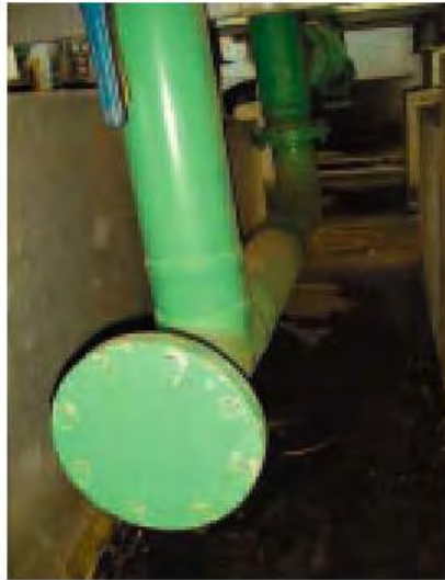
Εικόνα 15. «Τυφλό» σημείο στο δίκτυο σωληνώσεων ενός πύργου ψύξης (Public Health Division Victorian Government Department of Human Services Melbourne Victoria, 2001).
