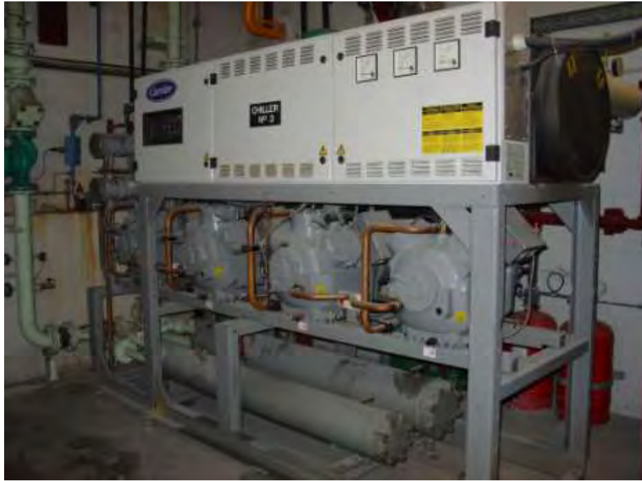
Εικόνα 13. Συμπυκνωτές ψυκτικού μηχανήματος
