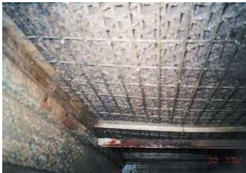
Εικόνα 16. Ανάπτυξη βιομεμβράνης και αλάτων σε επιφάνεια εναλλαγής θερμότητας πύργου ψύξης
