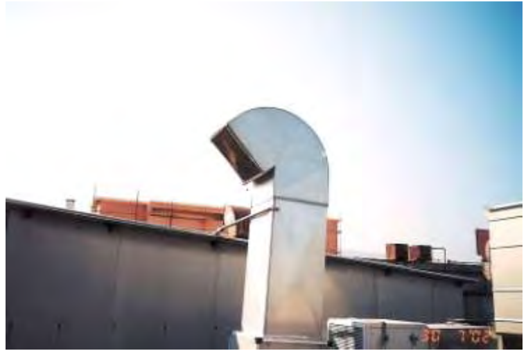
Εικόνα 11. Αεραγωγός του κτηρίου
