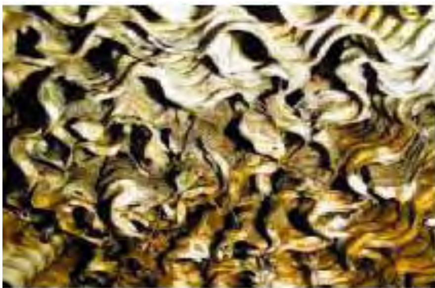
Σχήμα 5: Βιομεμβράνη στην επιφάνεια εναλλαγής της θερμότητας ενός πύργου ψύξης
