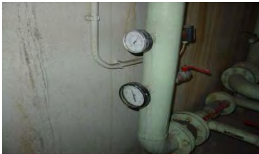
Εικόνα 14. Σωληνώσεις κρύου νερού με μετρητές πίεσης και θερμοκρασίας
