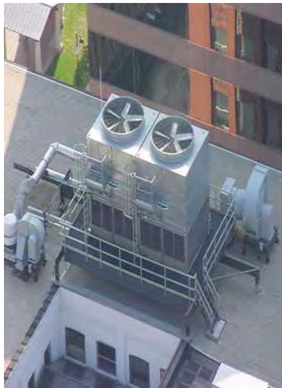
Πύργος ψύξης αντιροής με ανεμιστήρα κατάθλιψης
