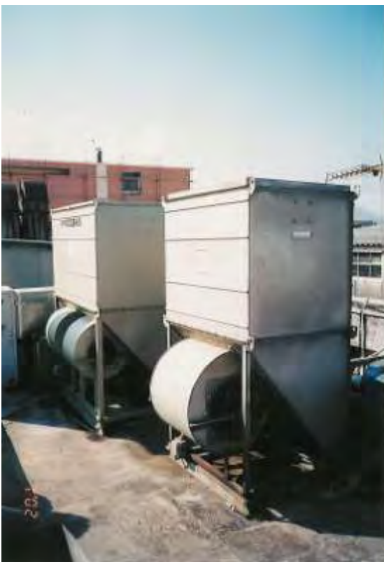
Πύργος ψύξης αντιροής με ανεμιστήρα κατάθλιψης
