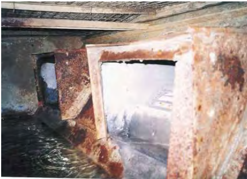
Εικόνα 17. Δεξαμενή πύργου ψύξης με ορατή διάβρωση
