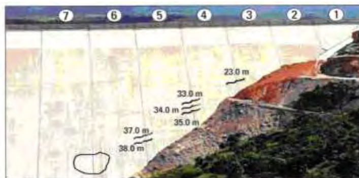
Εικ. 18: Itarébi: η θέση των ρωγμών στις πλάκες από σκυρόδεμα
