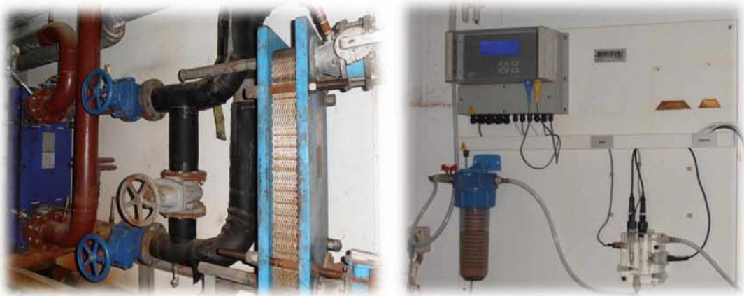
Εικόνα 2.11 Εναλλάκτες θερμότητας και σύστημα χλωρίωσης πισίνας.
