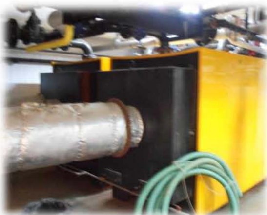
Εικόνα 2.15 Δύο λέβητες πετρελαίου εκτός λειτουργίας.
