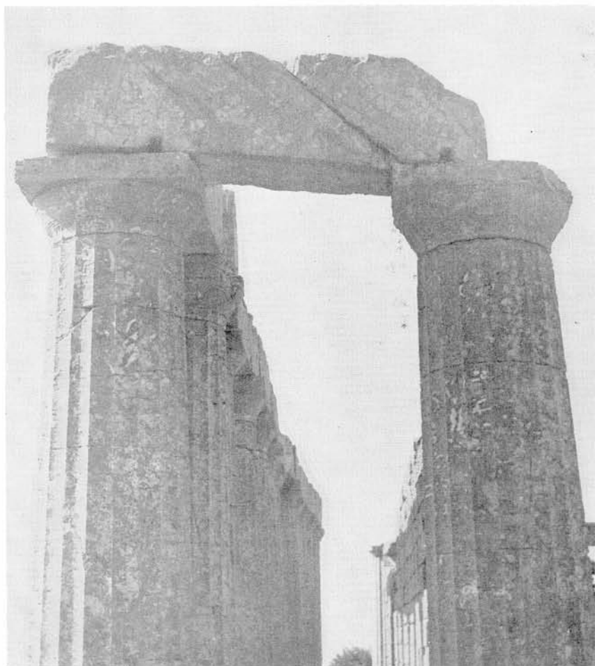
Ἡλεία. Ναός Ἐπικουρίου Ἀπόλλωνος Βασσῶν : α. Τὸ ἐτοιμόρροπον ἐπιστύλιον κατὰ τὴν ἀνατολικὴν πλευρὰν τοῦ ναοῦ μετὰ τοῦ αὐτόθι ἐτοιμορρόπου κιονοκράνου, β. Τὸ ἐτοιμόρροπον ἐπιστύλιον παρά τὴν ΒΑ. γωνίαν τῆς βορείας πλευρᾶς τοῦ ναοῦ μετὰ τοῦ δευτέρου ἀπὸ τῆς αὐτῆς γωνίας κίονος πρὸ τῆς ἀποκαταστάσεως αὐτῶν
