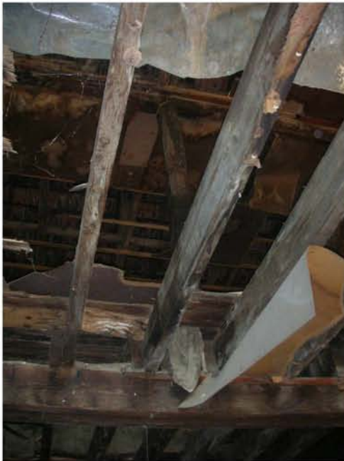
E49. Το κατεστραμμένο δάπεδο του ορόφου, όπως φαίνεται από το ισόγειο. Πηγή: Προσωπικό Αρχείο
