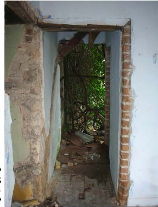
E51. Η μια από τις όψεις της προσθήκης του 1955, τμήμα της οποίας έχει καταρρεύσει, όπως φαίνεται εσωτερικά. Πηγή: Προσωπικό Αρχείο
