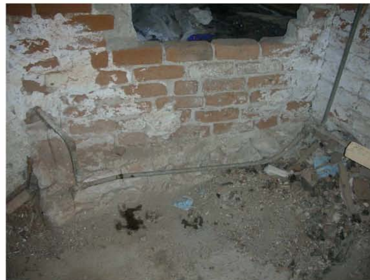
E45. Τα εσωτερικά χωρίσματα του κτιρίου κατασκευασμένα από οπτοπλινθοδομή. Πηγή: Προσωπικό Αρχείο
