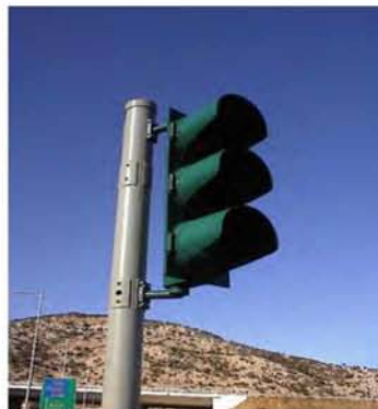
Φωτογραφία β –Σηματοδότης ρύθμισης κυκλοφορίας σε χαμηλό ιστό (Φ300 ΟΧ / 3 πεδίων)
