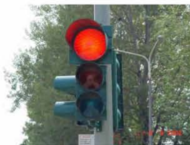
Φωτογραφία στ–Σηματοδότης ρύθμισης κυκλοφορίας σε ιστό με βραχίονα (Φ300/200 ΟΧ / 3 πεδίων)
