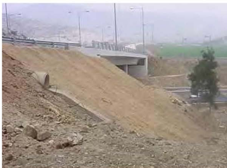
Φωτογραφία 3.6.8.α – Έξοδος αγωγού αποχέτευσης
