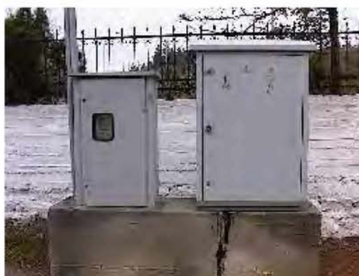
Φωτογραφία 3.12.2.β – Πίνακας ηλεκτρικής διανομής (αριστερός πίνακας) για τροφοδοσία φωτεινής σηματοδότησης
