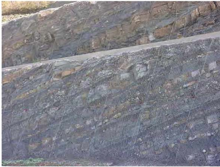
Φωτογραφία 3.9.4.α – Δίκτυ συγκράτησης καταπτώσεων
