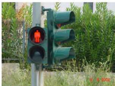
Φωτογραφία ζ –Σηματοδότης ρύθμισης κυκλοφορίας σε ιστό με βραχίονα (Φ200 Π – Φ300 ΟΧ / 3 πεδίων)
