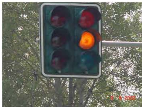
Φωτογραφία ε –Σηματοδότης ρύθμισης κυκλοφορίας σε ιστό με βραχίονα (Φ300 ΟΧ - Φ300 ΟΧ / 3 πεδίων)
