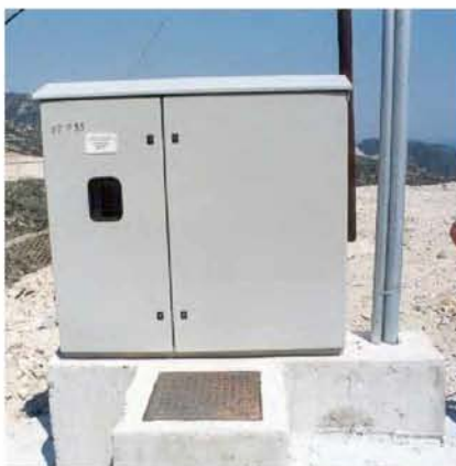
Φωτογραφία 3.12.2.α – Πίνακας ηλεκτρικής διανομής για τροφοδοσία οδοφωτισμού
