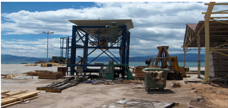
Εικόνα 22. Σιλό για αδρανή υλικά
