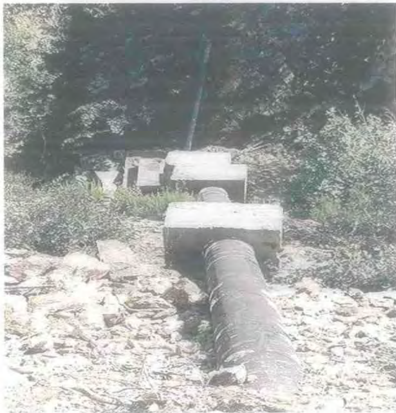
Αγωγός μεταφοράς νερού από πηγή Ξηράκια
