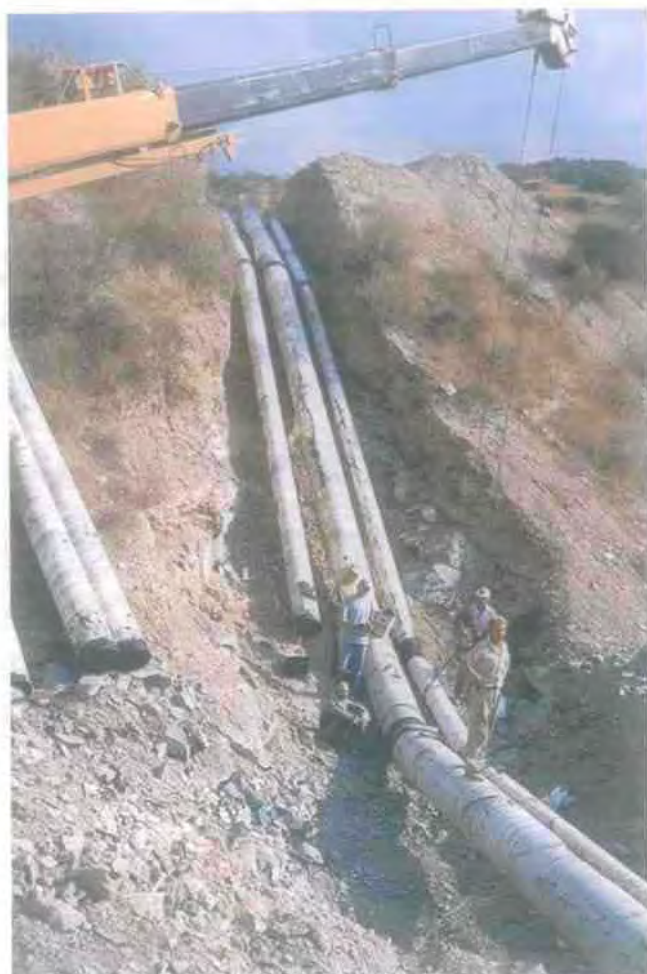
Αγωγός μεταφοράς νερού από δεξαμενή Λατομείου στη δεξαμενή Γηροκομείου.
