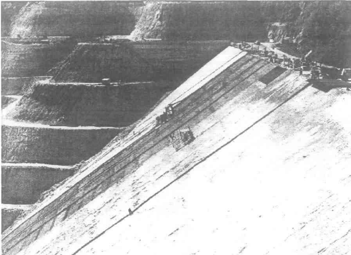
Φωτογραφία 2.14 : Γενική άποψη του εργοταξίου κατά την κατασκευή της ανάντη πλάκας σκυροδέματος (ΥΗΕ ΜΕΣΟΧΩΡΑΣ Ιούλιος 1994 – Αρχείο ΔΕΗ).
