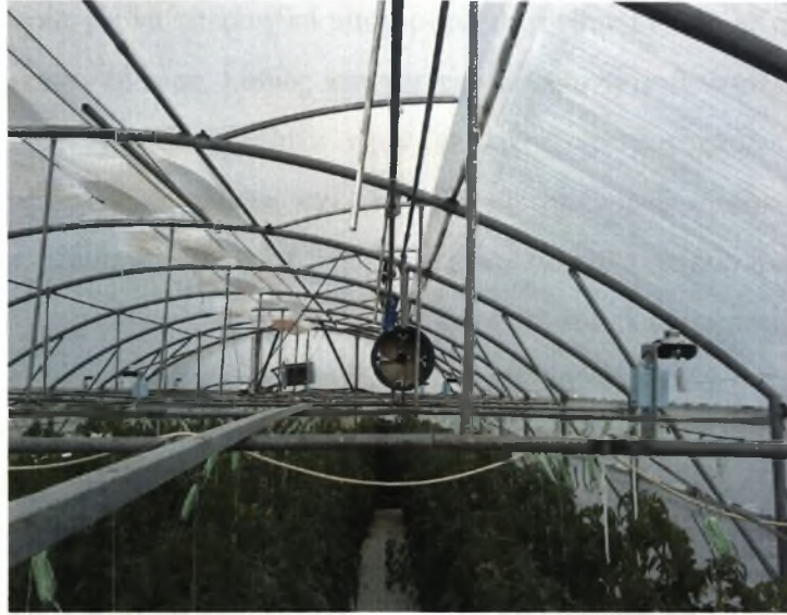
Εικόνα 3.3. Ανεμομείκτης αέρα στο εσωτερικό του θερμοκηπίου
