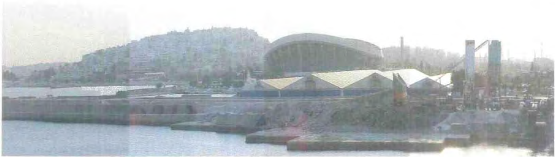
Φ. 14 Άποψη της περιοχής της Καστέλας, του ΣΕΦ, ενός εκθεσιακού κέντρου (παράνομου) και του εργοταξίου για την ολοκλήρωση της Λεωφ. Κηφισίας
