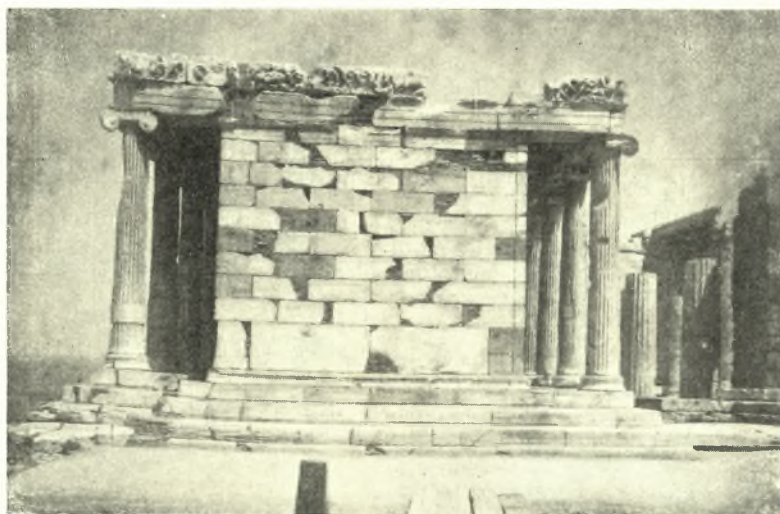
Εἰκ. 1. Ἡ πρὸ μεσημβριάν ἀποψις τοῦ ναοῦ ἐν ἧ ἐμφαίνεται ἡ καθίζησις τοῦ κρηπιδώματος.
