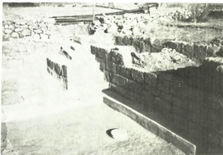
Mallia : a. Une partie de la couverture translucide du complexe K(appa). b. Restauration de la porte et de la fenêtre de la crypte K, c. Entrées occidentales de la crypte hypostyle, après restauration
