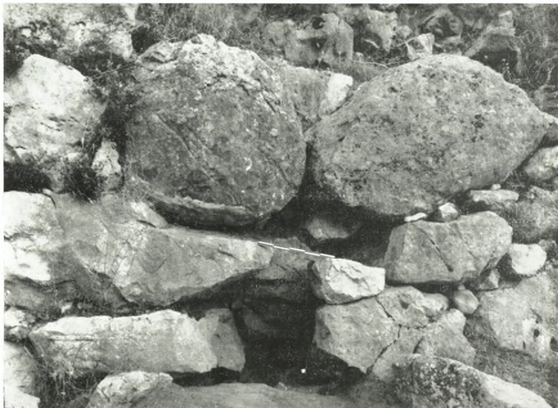
Εἰκ. 22. Στόμιον ὑπονόμου εἰς τὴν περιοχὴν Θ τοῦ βορείου τείχους πρὸ τῆς ἀναστηλώσεως.
