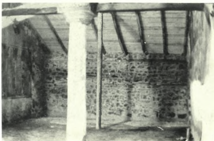
Μακεδονία. Βέροια: α. 'Ο ναός 'Αγίου 'Ιωάννου Θεολόγου μετά τὰς ἐργασίας ἀποκατάστασης, β - γ. 'Ο νότιος ἐξωτερικός τοίχος τοῦ 'Αγ. Γεωργίου πρὸ καὶ μετὰ τὴν ἀποκατάστασιν
