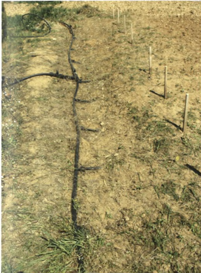
Εικόνα 4.5.1. Το διπλό υπόγειο δίκτυο άρδευσης.
