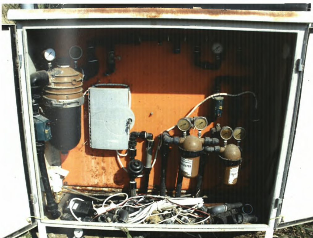
Εικόνα 4.5.12. Μηχανολογικός εξοπλισμός που περιλαμβάνει την ηλεκτροβάνα του λύματος, φυλασσόμενος σε ειδικά διαμορφωμένο κουτί.
