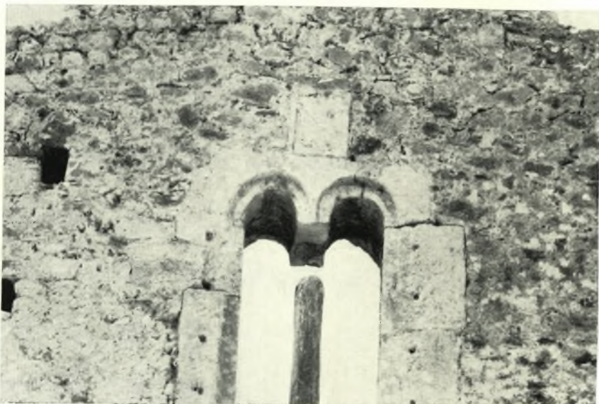
α. "Άγιος Λέων Μεθώνης. Τὸ παράθυρον τοῦ νοτίου τυμπάνου τῆς ἐγκαρσίας καμάρας με ἐντοιχισμένον θυρεόν.
