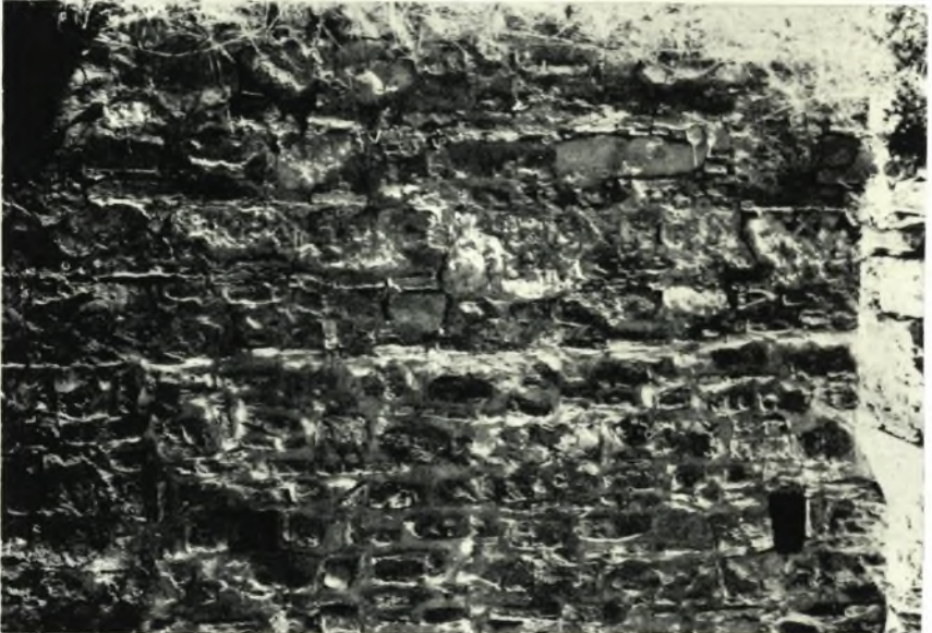
α. "Αγιος Λέων Μεθώνης. Τοιχοδομία τῆς νοτίας ὀψευς (μεταξὺ τῶν τρίτης καὶ τετάρτης ἀπὸ Δ. ἀντηρίδων).
