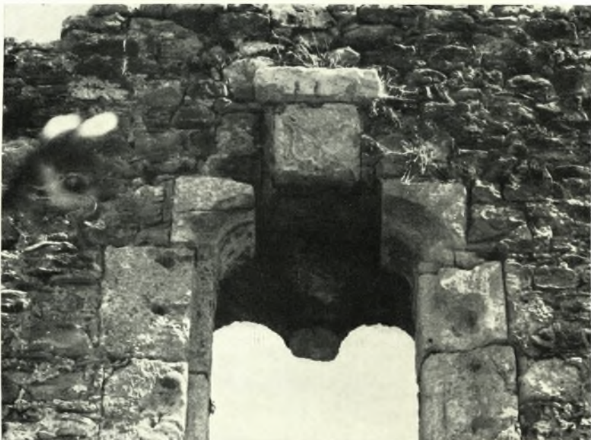
β. "Άγιος Λέων Μεθώνης. Παράθυρον τοῦ βορείου τυμπάνου τῆς ἐγκαρσίας καμάρας με ἐντοιχισμένον θυρεόν.
