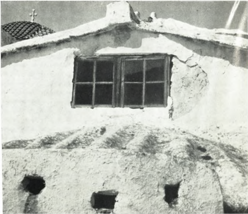
α. Τὸ ὑπεράνω τῆς ἀψίδος τοῦ Ἁγ. Νικολάου ἀνοιγμα πρὸ τῶν ἐργασιῶν ἀποκαταστάσεως αὐτοῦ.
