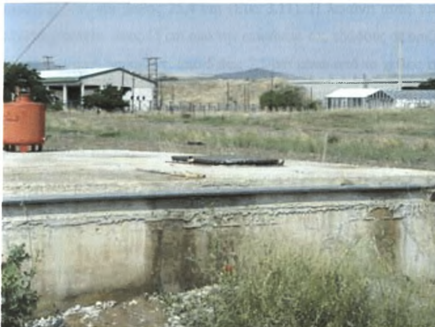
Εικόνα 3.9 Δεξαμενή συγκέντρωσης νερού άρδευσης
