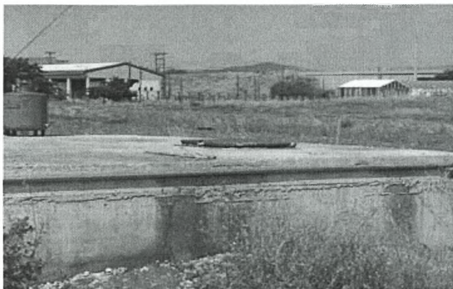
Εικόνα 4.9 Δεξαμενή συγκέντρωσης νερού άρδευσης
