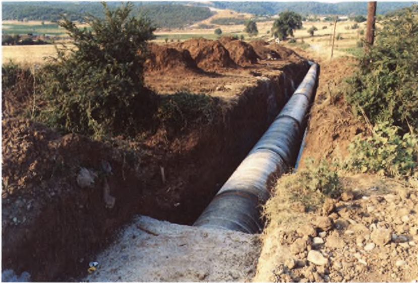
Εικόνα 113 : Τροφοδοτικός αγωγός Φ 600 (Σπυριδώνης Ι., τοπογράφος-μηχανικός).
