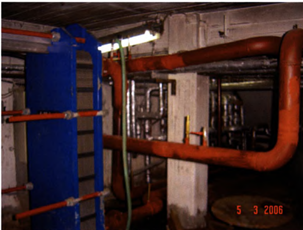
Φωτογραφία 5.4-Πλακοειδής εναλλάκτης νερού-νερού με σκοπό την θέρμανση των Γραφείων του Διοικητηρίου εκμεταλλευόμενος την ενέργεια του νερού του Σ.Η.Θ.. Το έργο αυτό ολοκληρώθηκε στις 20/10/2005 με ικανοποιητικά αποτελέσματα, ενώ αντικαταστάθηκαν λέβητες πετρελαίου ονομαστικής ισχύος 257.000 kcal/h, οι οποίοι εργάζονταν χωρίς αυτονομία.
