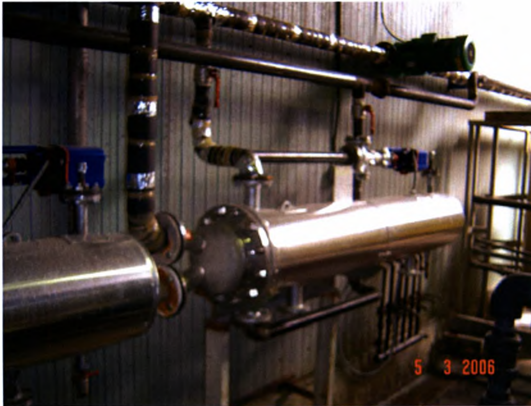
Φωτογραφία 5.6-Δύο εναλλάκτες νερού-νερού Τμήματος Κατακόρυφης Ηλεκτροστατικής Βαφής ονομαστικής ισχύος 400kW (344.234kcal/h) έκαστος
