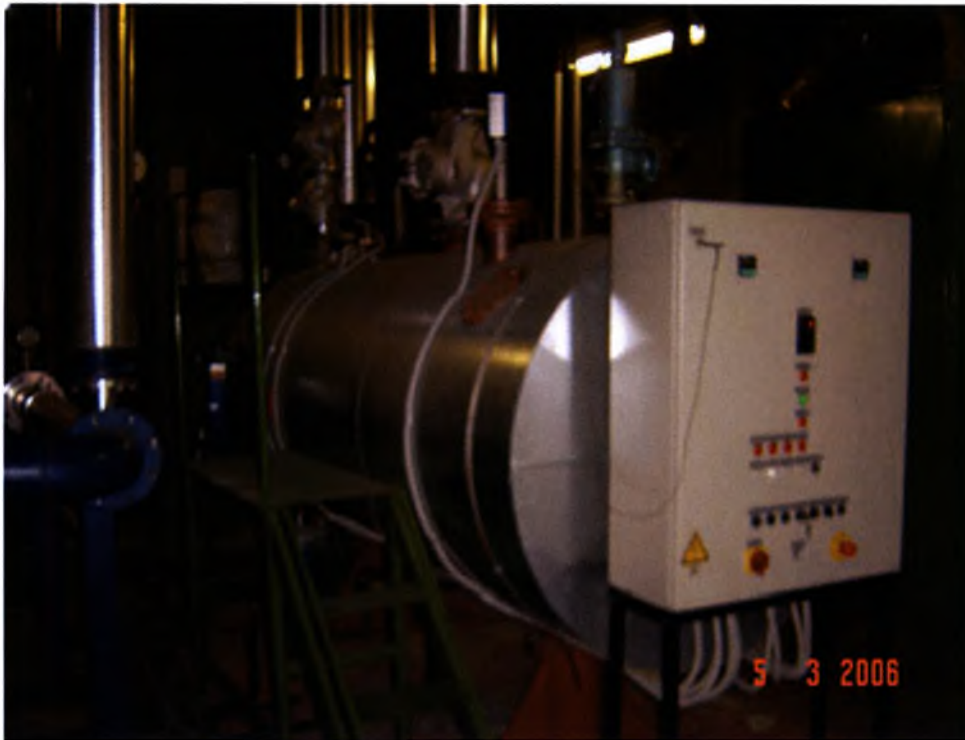
Φωτογραφία 5.3-Εναλλάκτης λαδιού-ατμού Εργοστασίου ΒΙΟΚΑΡΠΕΤ Α.Ε. με ονομαστικά μεγέθη: G=3.5\text{t/h} ατμοπαραγωγή και P_{\text{θερμική}}=1.8\text{MW} της γερμανικής εταιρείας Maxxtec όπου φαίνονται ο ηλεκτρικός πίνακας με τους αυτοματισμούς, η παροχή ατμού και οι σωλήνες προσαγωγής-επιστροφής λαδιού.
