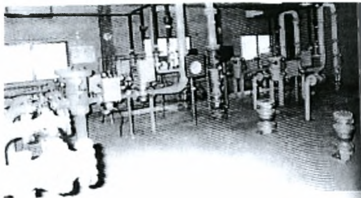
Εικόνα Ε4: Σταθμός ελέγχου και μετρήσεων δικτύου
