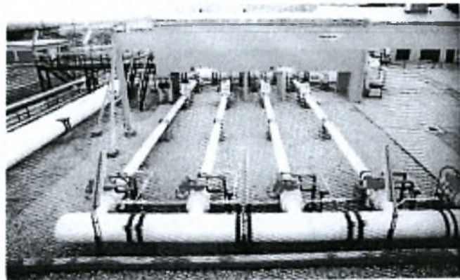
Εικόνα Ε3: Μετρητικός σταθμός στο Στρυμονοχώρι Σερρών
