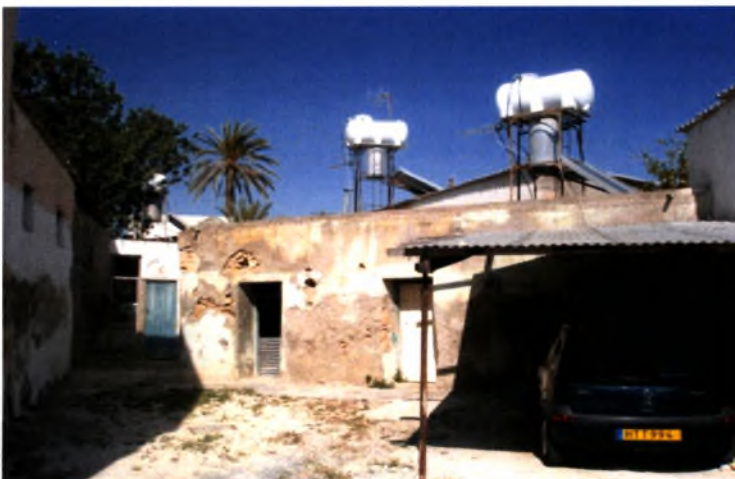
Φωτογραφία 45: Κτίριο σε κακή δομική κατάσταση στο δυτικό τμήμα του παραδοσιακού πυρήνα
