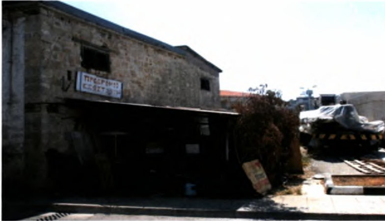
Φωτογραφία 34: Κατάστημα επί της οδού Φελλάχογλου σε άσχημη κατάσταση Πηγή: Προσωπικό αρχείο)
