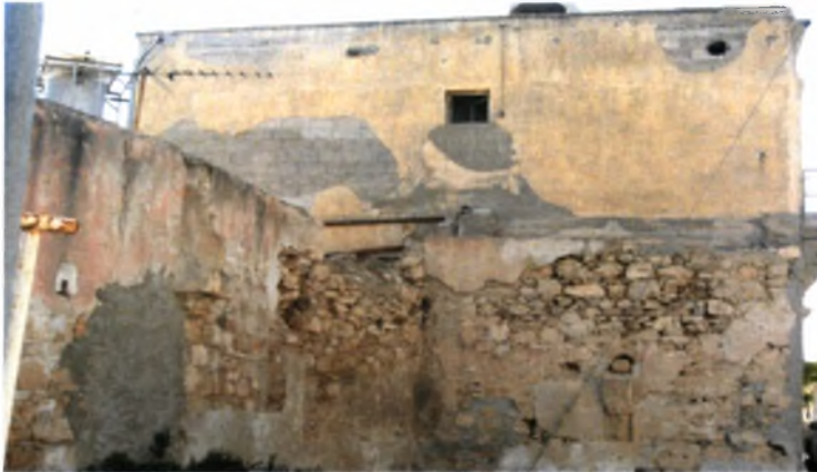
Φωτογραφία 37: Κτίριο σε κακή δομική κατάσταση στο ενδιάμεσο τμήμα του παραδοσιακού πυρήνα –(αρσένες)
