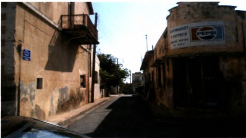
Φωτογραφία 35: Κτίριο σε άσχημη δομική κατάσταση στο ανατολικό τμήμα του παραδοσιακού πυρήνα
