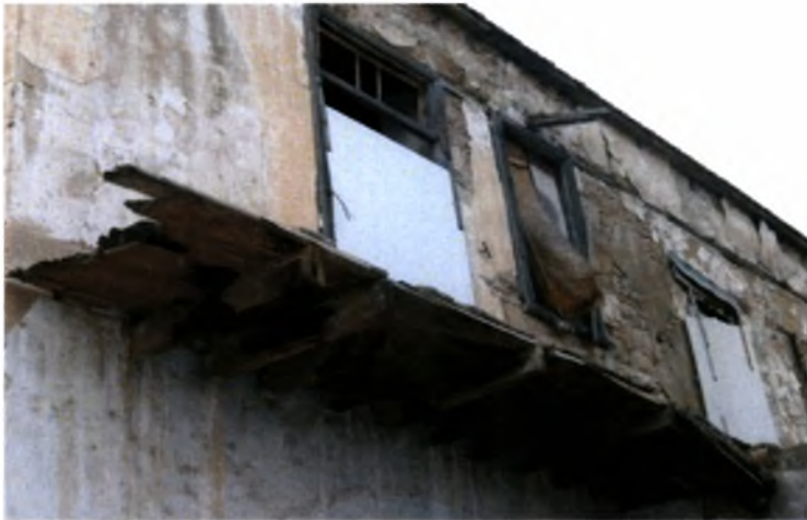
Φωτογραφία 40: Κακή δομική κατάσταση κτιρίου στο ενδιάμεσο τμήμα του παραδοσιακού πυρήνα
