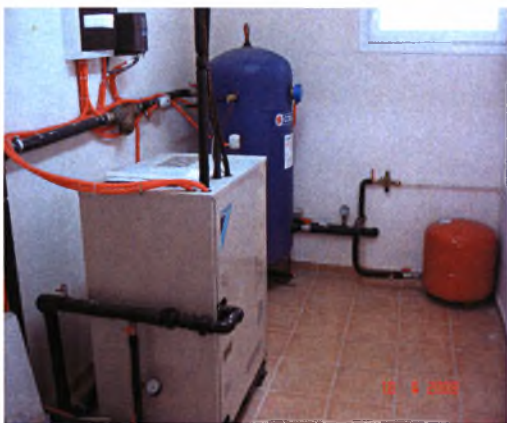
Σχήμα 5.2: υδρόψυκτη αντλία θερμότητας
