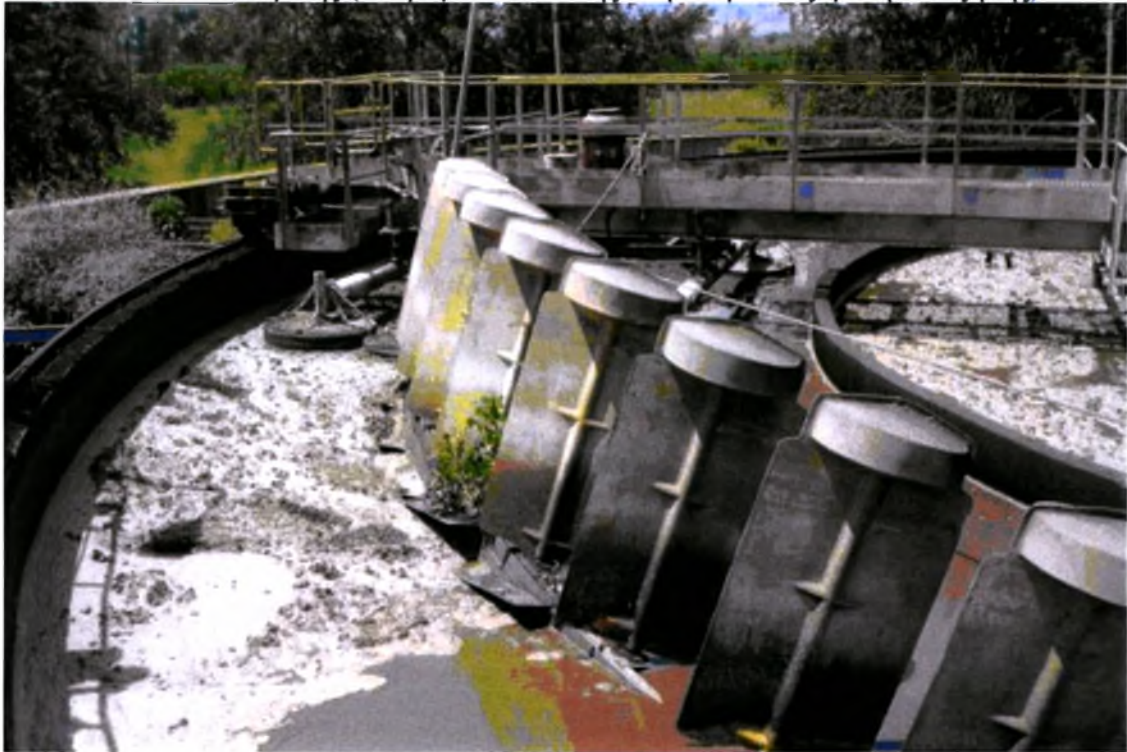
Εικόνα 1: ΕΕΛ Κατερίνης (Πτερύγια ανάδευσης στην κύρια δεξαμενή καθίζησης)
