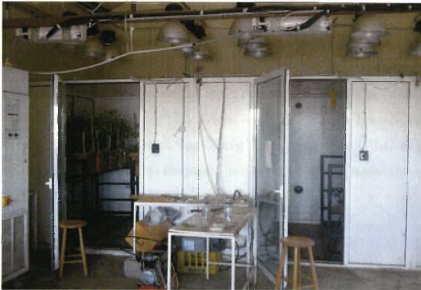
Εικόνα 4. Θάλαμοι control και ozone
